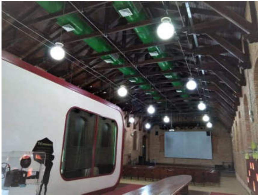
Imagem com sistema de refrigeração existente, implantado durante as intervenções para implantação da prefeitura no Palácio no início da década de 1990.
