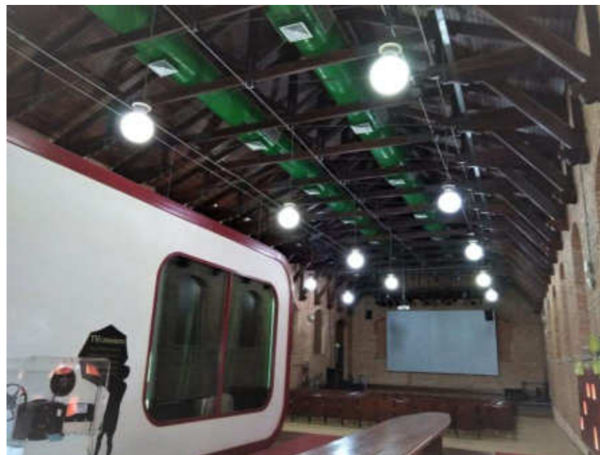
Imagem do Pavilhão "A", com sistema de refrigeração existente, implantado durante as intervenções para implantação da prefeitura no Palácio no início da década de 1990.
