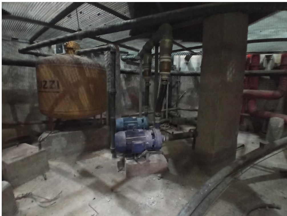
3.1 → Nível - 1,45 ao + 0,10 / 2 Bombas de 15 CV
