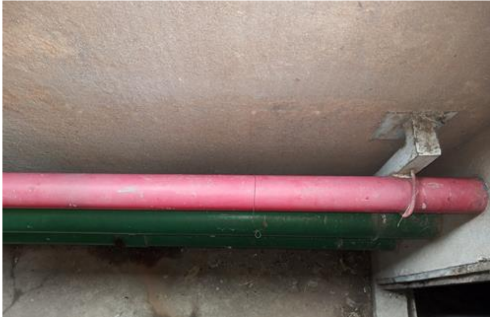
Detalhe das tubulações nas galerias
